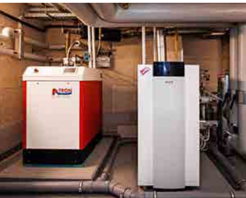
Die Kölner GAG nutzt moderne Heizanlagen, die mittels Kraft-Wärme-Kopplung sowohl Wärme als auch Strom erzeugen, der auch direkt an die Mieter abgegeben wird
